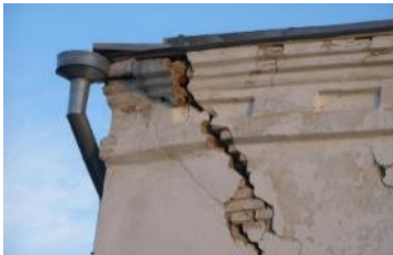
Фото1. Поява вертикальної тріщини внаслідок прильоту ворожого КАБУ поруч будівлею
